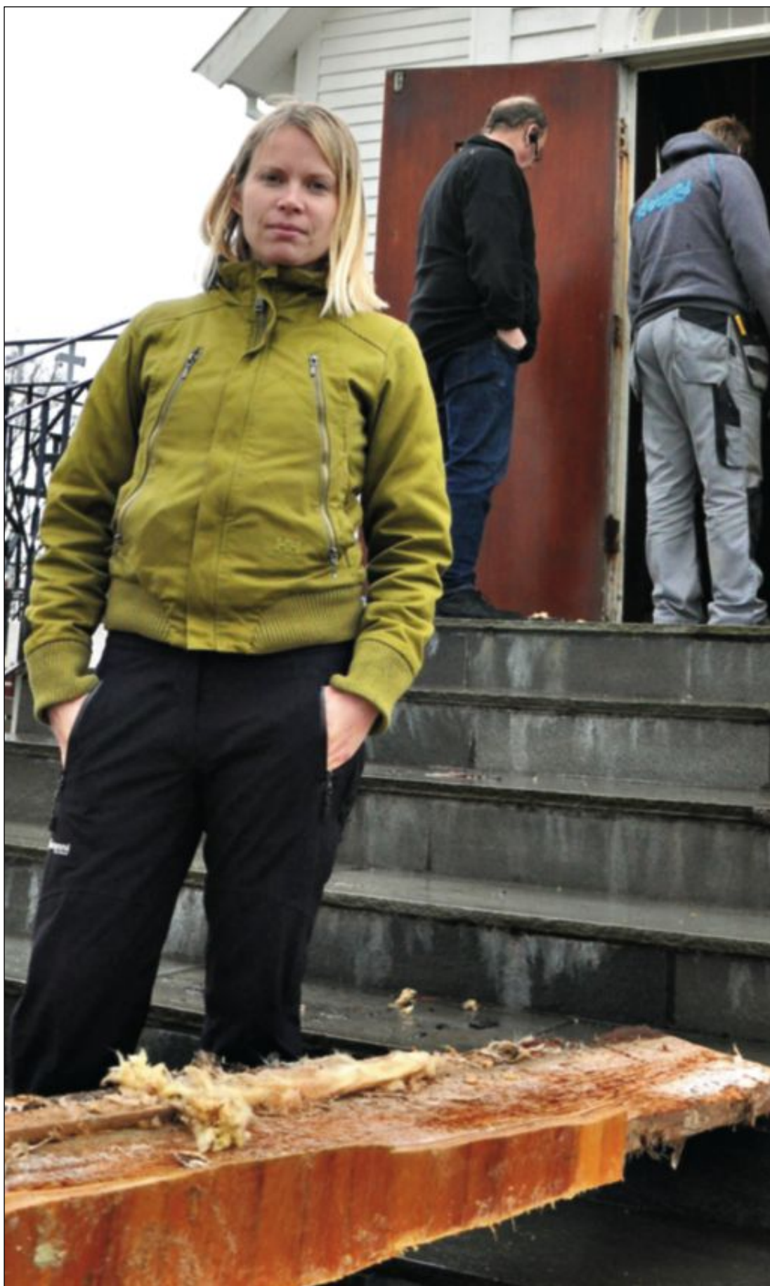
HÅPER PÅ SVAR ONSDAG: Arbeidarane har enno ikkje full oversikt over omfanget av skadane frå vatn og ekte hussopp i Emigrantkyrkja. Avdelingsleiar Ida Dyrkorn Heierland ved Vestnorsk Utvandringssenter håpar dei får svar på synfaringa onsdag. (Foto: Anne-Lise Nordpoll)
